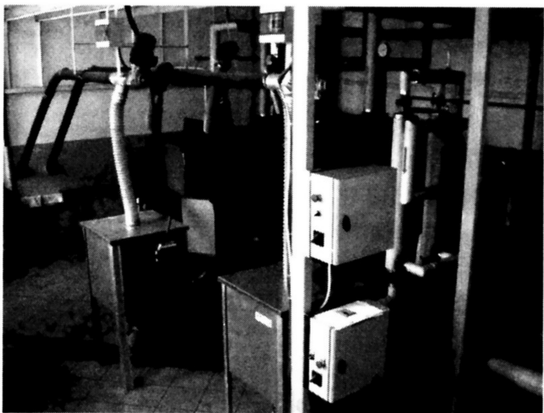
Nowoczesna kotłownia c.o.
